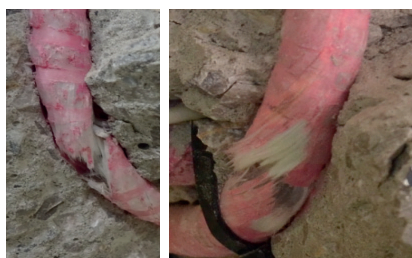
Photo 1. Stirrups failure in the corner after removal of the concrete cover Photo: author Fot. 1. Zniszczenie strzemion w narożniku po odkuciu otuliny betonowej Fot: autor
