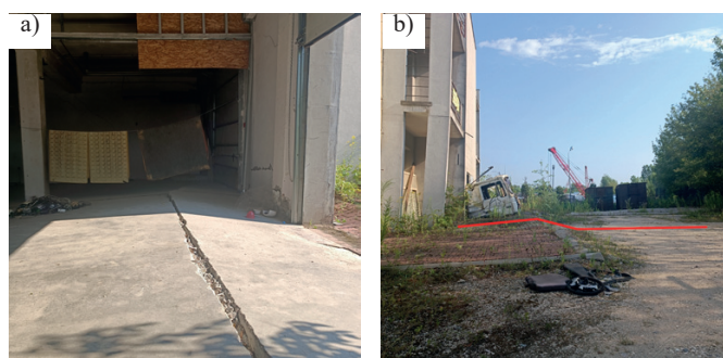
Photo 2. Deformations of the building elements (a) and the surface of the adjacent land – red line (b) Fot. 2. Deformacja elementów budynku (a) oraz powierzchni terenu przyległego – linia czerwona (b)
