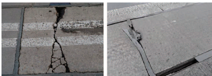
Photo 6. Damage to the surface of the tram-bus track Fot. 6. Uszkodzenia nawierzchni torowiska tramwajowo-autobusowego
