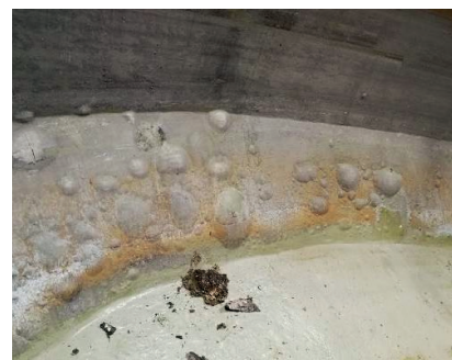
Photo 4. Numerous osmotic bubbles on the tank surface Fot. 4. Liczne pęcherze osmotyczne na powierzchni zbiornika
