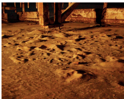
Photo 3. Osmotic bubbles in the tank's bottom plate Fot. 3. Pęcherze osmotyczne w płycie dennej zbiornika
