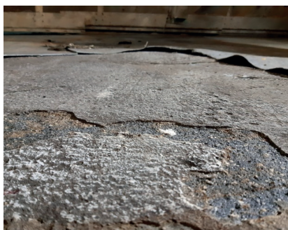
Photo 2. Multiple layers of polyurea and a poorly constructed concrete substrate Fot. 2. Wiele warstw polimocznika i niedbale wykonane podłoże betonowe
