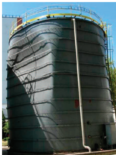
Photo 3. Deformed tank shell after removal of mineral wool insulation Fot. 3. Zdeformowany płaszcz zbiornika po demontażu ocieplenia z wełny mineralnej
