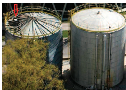
Photo 4. View of deformed tank roof after removal of mineral wool insulation Fot. 4. Widok zdeformowanego dachu zbiornika po demontażu ocieplenia z wełny mineralnej
