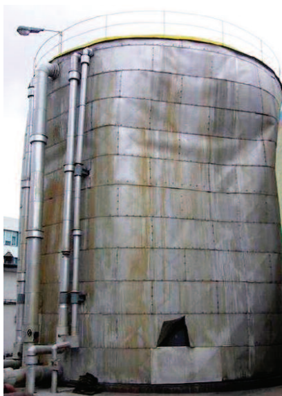
Photo 2. Deformations of the tank shell Fot. 2. Deformacje płaszcza zbiornika
