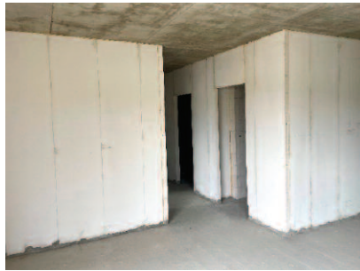
Photo 2. Partition walls made of modular AAC panels in multi-family building in Łomża Fot. 2. Ściany działowe z modułowych paneli z ABK w budynku wielorodzinnym w Łomży
