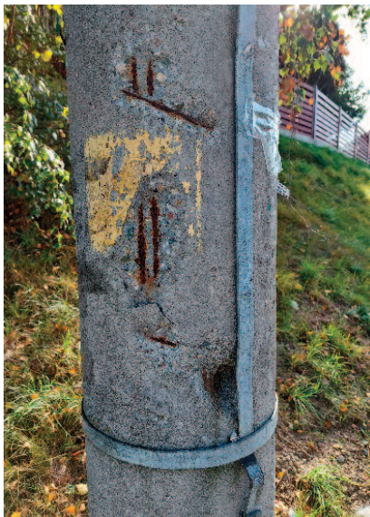
Fot. 5. Skorodowane zbrojenie uzwojające oraz podłużne w postaci splotu i pręta żebrowanego
