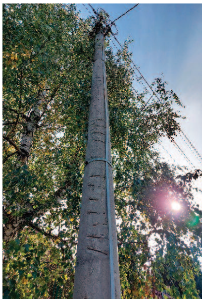
Fot. 6. Słup E12/4,3 z odsłoniętą i skorodowaną spiralą
