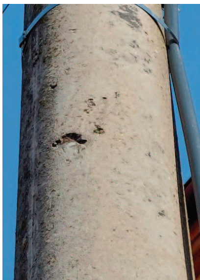
Fot. 4. Kawerna (wnęka) powstała w wyniku wymycia przez deszcz prawdopodobnie bryłki stwardniałego cementu
