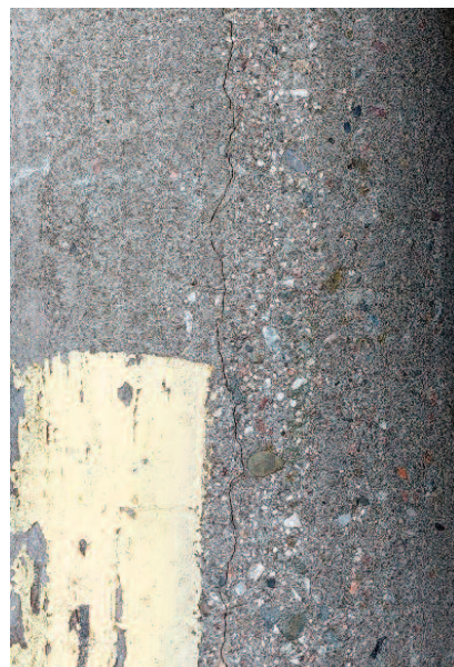
Fot. 7. Wzdłużne pęknięcie na wysokości słupa przelotowego E12/2,5
