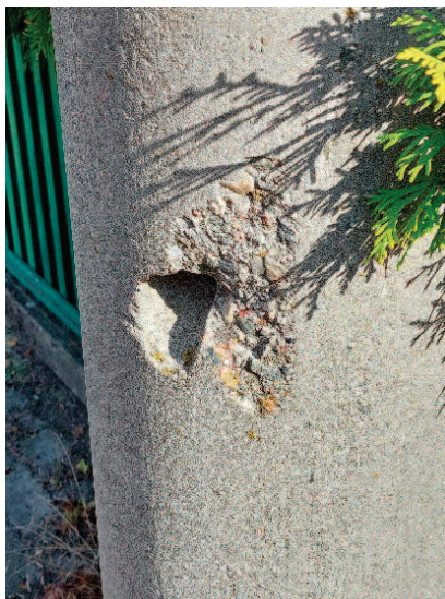
Fot. 3. Odłupanie krawędziowe betonu przy otworze wentylacyjnym powstałe podczas ustawiania słupa w pionie
