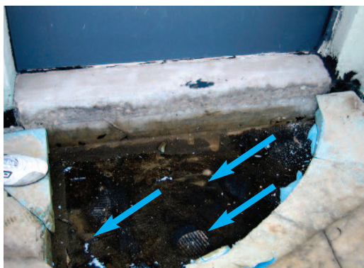
Widok grubowarstwowej powłoki asfaltowej modyfikowanej polimerami przy progu drzwi prowadzących na taras, ze śladami miejscowego ograniczenia grubości warstwy. Strzałkami pokazano przykładowe miejsca obniżenia grubości powłoki w rejonie zwiększonych miejscowych nacisków
