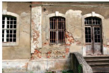
Fot. 3. Zawilgocenia ścian, ubytki tynków, uszkodzenia pilastrów
