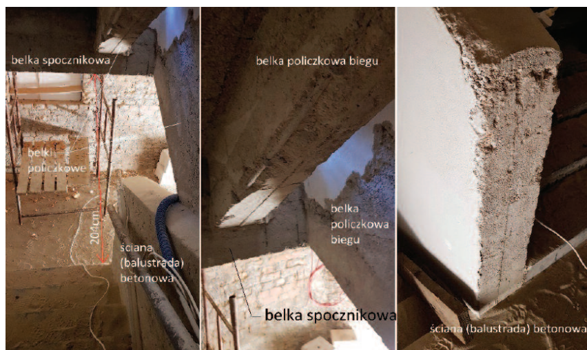
Fragment klatki schodowej przeznaczonej do adaptacji do wymagań przepisów – wysokość w świetle 204 cm < 220 cm (wymagana)
