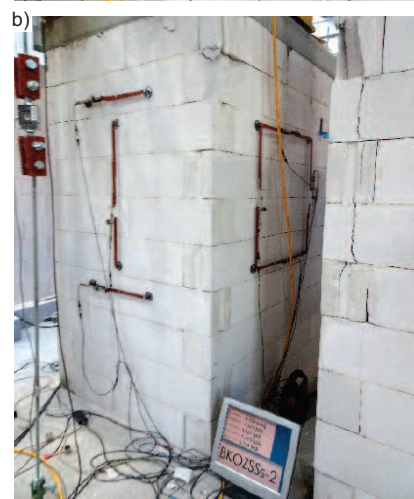
Fot. 3. Zniszczenie modeli zbrojonych siatką stalową: a) BKOZSS-1; b) BKOZSS-2
