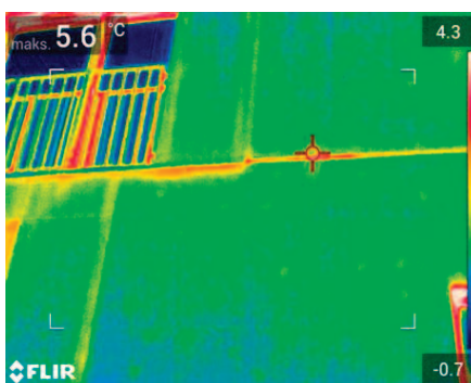
Fot. 2. Zdjęcie termowizyjne elewacji południowo-zachodniej budynku F Photo 2. Thermovision image of the south-western facade of building F
