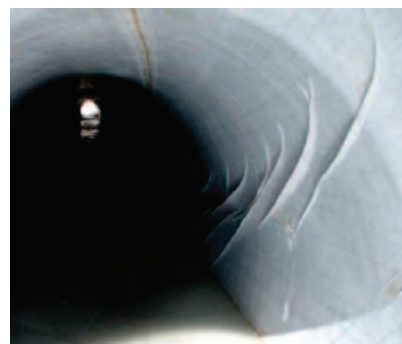
Fot. 3. Przykładowe wady wykładziny rejestrowane podczas inspekcji CCTV [14] Photo 3. Examples of liners defects recorded during CCTV inspections [14]
