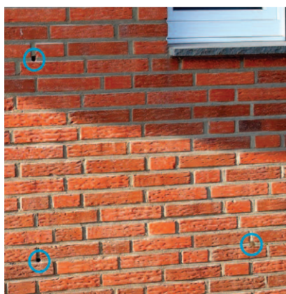
Przykładowe otwory w spoinie cegły służące do aplikacji trzykomponentowego systemu pianowego BASF Cavior® Examples of holes in a brick joint for three-component application BASF Cavior foam system
