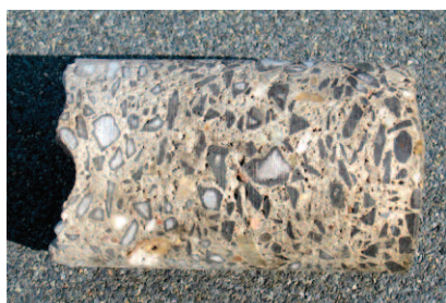
Fot. 1. Struktura badanego betonu na przykładzie odwiertu O-8 Photo 1. The structure of the tested concrete on the example of the core O-8
