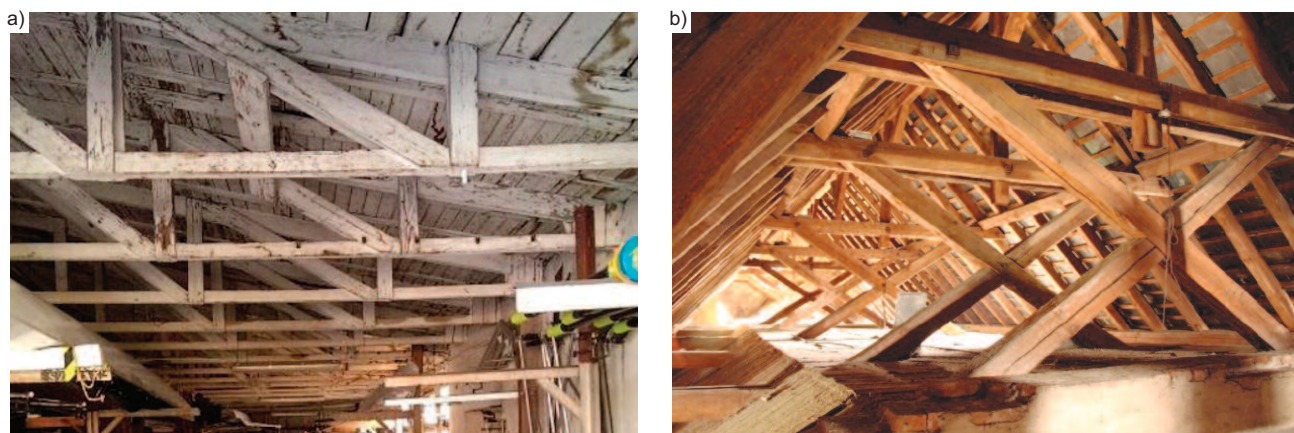
Fot. 1. Przykładowe więzby dachowe wymagające oceny stanu technicznego: a) kratownicowa więzba hangaru kajakowego przy ul. Kościuszki w Krakowie; b) więzba dachowa kościoła pw. św. Krzyża w Podlegórze Fot. Autor Fig. 1. Examples of roof rafter framing in need of technical condition assessment: a) the truss rafter framing of the canoe hangar at Kościuszki Street in Kraków; b) the roof rafter framing of Holy Cross Church in Podlegórze Photo Author
