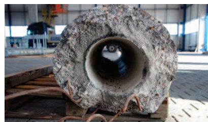
Fot. 2. Żerdź E15/4,3 od strony zniszczonej Photo 2. The E15/4.3 pole from the damaged side
