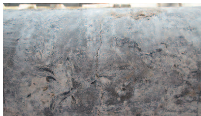
Fot. 4. Rysa poprzeczna o szerokości w = 0,8 mm w odległości ok. 1,28 m od nasady świadcząca o przeciążeniu żerdzi podczas próby jej pionowania Photo 4. A transverse crack with a width of w = 0,8 mm at a distance of about 1.28 m from the base of the pole proving its overload during the verticalization attempt of the pole
