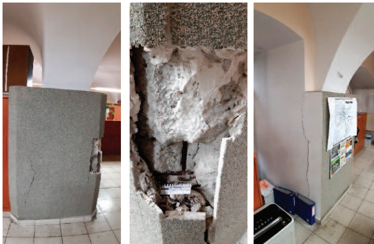
Fot. 5. Uszkodzenia opasek żelbetowych [8] Photo 5. Damage to reinforced concrete bands [8]
