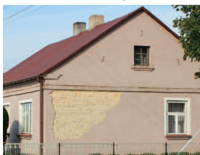
Fot. 6. Ubytki tynku na elewacji budynku z kamienia wapiennego
