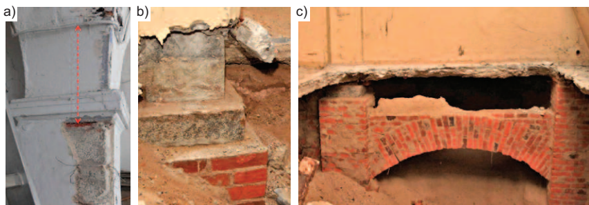
Fot. 3. Stajnia nr 3, 2021 r.: a) piaskowcowa głowica kolumny wzmocniona w 1937 r. przez obetonowanie; b) podstawa granitowego filara z odkutym betonowym wzmocnieniem; c) odkrywanie fundamentu pod pilastrem i łęk usztywniający
