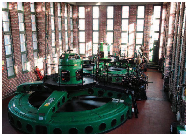
Generatory znajdujące się w hali maszyn budynku elektrowni
