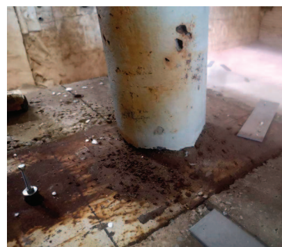
Fot. 1. Zniszczona podstawa słupa po badaniu obciążeniowym Photo 1. Destroyed column base after the load test
