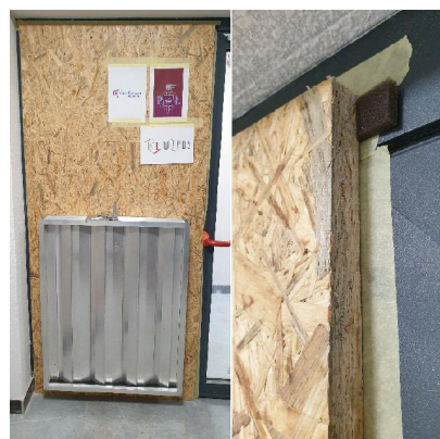
Fot. 2. Klapa rozszczelniająca w drzwiach zewnętrznych klatki
