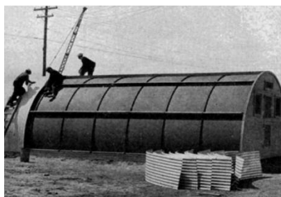
Fot. 2. System Quonset Hut – montaż okładzin [1] Photo 2. Quonset Hut system – assembly of claddings [1]
