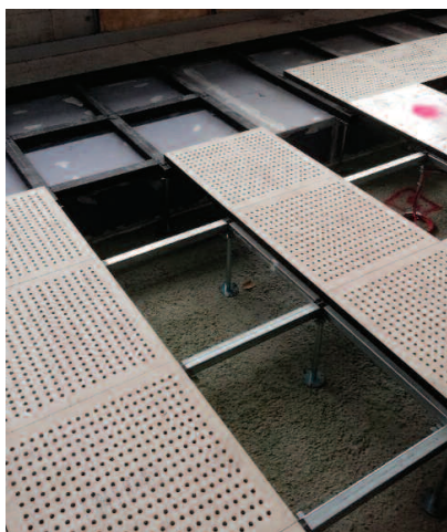
Fot. 1. Słupki wspornikowe oraz stalowy ruszt zabezpieczający instalację wentylacyjną
