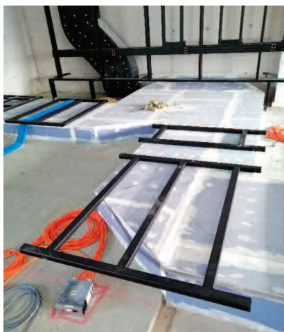
Fot. 6. Zabezpieczenie ogniochronne instalacji wentylacyjnej podpodłogowej Photo 6. Fire protection of the under-floor ventilation system
