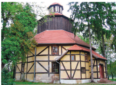
Fot. 1. Elewacja południowo-zachodnia kościoła w Sękowicach. Uszkodzony i zawilgocony cokół, skorodowana konstrukcja drewniana, znaczne ubytki tynku w murewanej ścianie wypełniającej konstrukcję słupowo-ryglową
