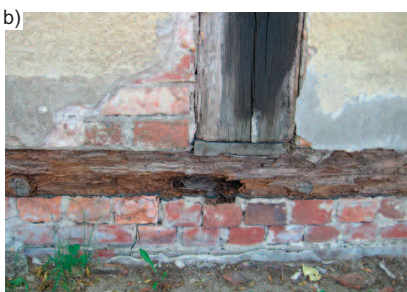
Fot. 2. Fragment elewacji północnej kościoła w Sękowicach: a) skorodowana drewniana konstrukcja słupowo-ryglowa, rozluźnione wiązanie cegieł, ubytki tynków, skorodowane daszki nad oknem parteru; b) skorodowana belka podwalinowa, rozluźnione wiązanie cegieł cokołu, ubytki tynków; szczelina uzupełniona wkładką z desek pomiędzy słupem a skorodowaną i zgniecioną belką podwalinową
