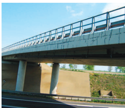
Fot. 2. Zarysowany gzyms wykonany z betonu „in situ”
