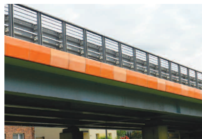
Fot. 1. Gzyms wykonany z wykorzystaniem prefabrykowanych płyt (desek) gzymsowych z betonu polimerowego (widoczne odbarwienia płyt)
