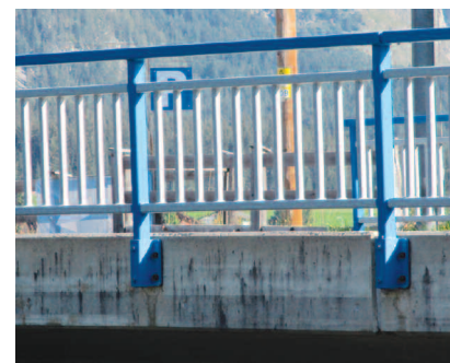
Fot. 3. Gzyms żelbetonowy wykonany z betonu „in situ”, monolitycznie połączony z tzw. kapą chodnikową (brak rys – widoczne lokalne zabrudzenia gzymsu)
