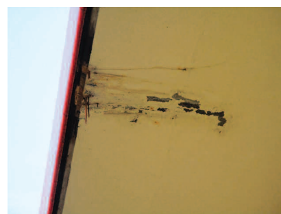
Fot. 5. Uszkodzenia powłoki ochronnej wspornika płyty pomostowej spowodowane wodą wypływającą spod płyt gzymsowych Photo 5. Damage to the protective coating of the deck plate due to water flowing out from under the cornice plates
