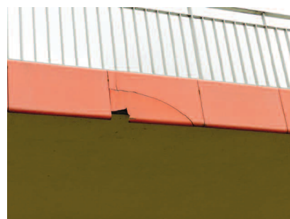
Fot. 6. Uszkodzenia mechaniczne (pęknięcia i ubytki) płyty gzymsowej Photo 6. Mechanical damage (cracks and cavities) of the cornice plate
