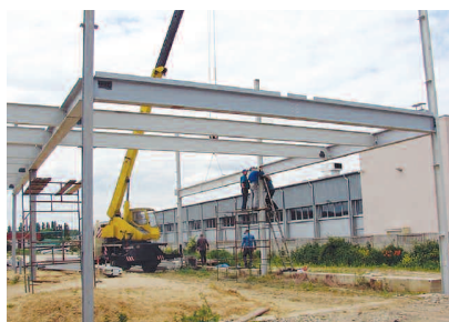
Fot. 3. Budowa stalowej konstrukcji nośnej budynku biurowo-magazynowego z przygotowanych zdemontowanych elementów konstrukcyjnych hali zakładów mięsnych
