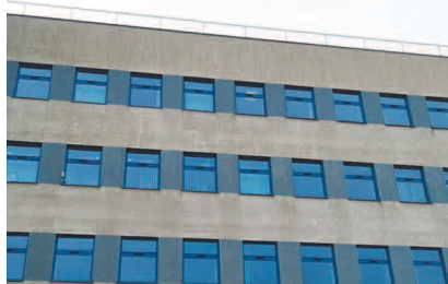
Fot. 1. Efekt „biedronki” na elewacji Photo 1. The „ladybird” effect on the facade
