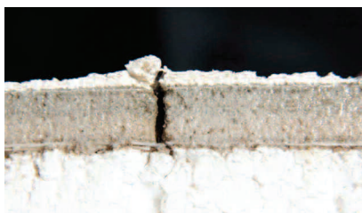
Fot. 2. Zbyt gruba warstwa wykończenia z siatką zatopioną tuż przy krawędzi płyty izolacyjnej
