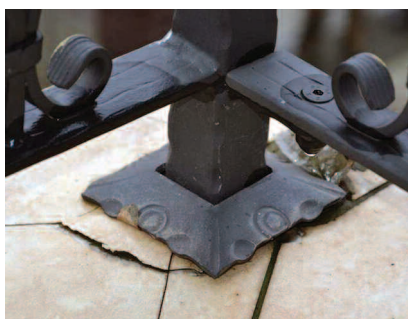
Fot. 2. Pęknięte płytki na tarasie w miejscu mocowania balustrady
