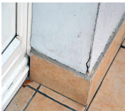
Fot. 1. Uszkodzenie tynku w narożu ściennym w obrębie tarasu
