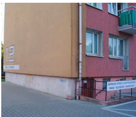
Fot. 1. Brak docieplenia strefy cokołowej budynku
