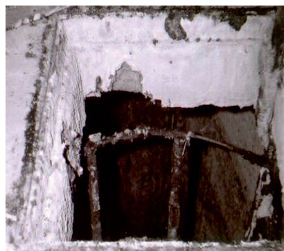
Fot. 1. Korozja betonu przez siarkowodor Photo 1. Corrosion of concrete by hydrogen sulphide
