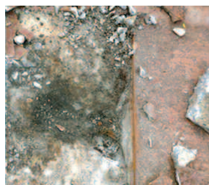
Fot. 3. Osadnik wstępny ze stalowymi zgarniaczami i uszkodzeniami dna Photo 3. Pre-settler with steel scrapers and bottom damage
