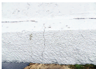
Rysy na pasie dolnym dźwigara sprężonego mostu
