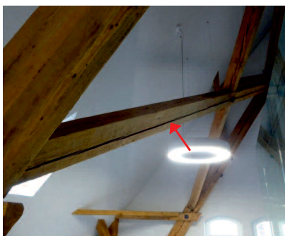
Fot. 3. Pęknięcie wzdłużne stężenia dachowego w postaci „krzyża św. Andrzeja”
