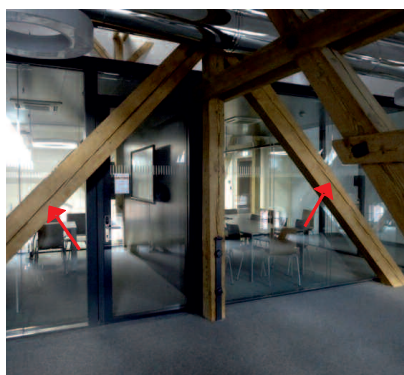
Fot. 2. Przykładowe pęknięcia wzdłużne ważnych elementów ściskanych więźby dachowej
