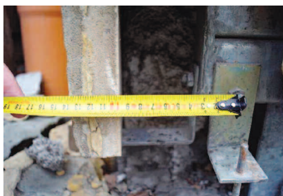
Fot. 3. Kątownicy z bednarki o szerokości 30 mm, grubości 3 mm, z pionowymi trzpieniami stalowymi \phi 4 mm (całość ocynkowana) do osadzenia punktowego płyt kamiennych, mocowane do ceowników poziomych na pojedynczą śrubę Photo 3. Hoop iron angles, 30 mm wide, 3 mm thick, with vertical steel pins \phi 4 mm (all galvanized), fastened to the horizontal channels for point setting of stone slabs
