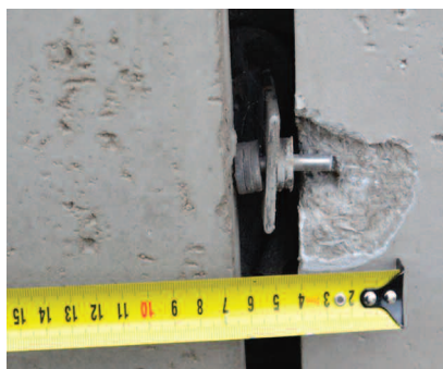
Fot. 3. Wylamana krawędź płyty po zastosowaniu kotwy kamiennarnej Photo 3. Broken edge of panel after using stone anchor
