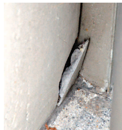
Fot. 5. Odsparcie płyty spowodowane lokalnym podparciem Photo 5. Detachment of prefabricated elements caused by local support
