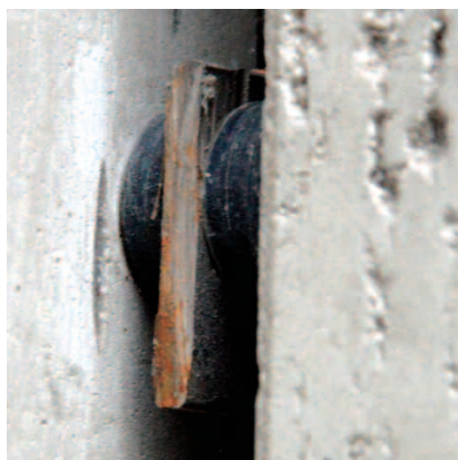
Fot. 6. Korozja stalowej kotwy jako zamiennik do nierdzewnej
