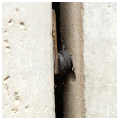
Fot. 7. Otwór po źle wytrasowanym wierceniu pod kotwę
