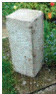
Fot. 1. Element murowy z ABK po czterdziestu latach składowania w warunkach polowych w północno-wschodniej części Polski
