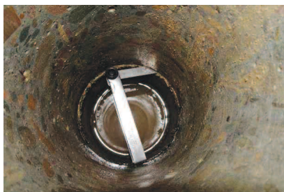
Fot. 7. Pomiar szczeliny między betonem podkładowym a betonem posadzki Photo 7. Measurement of the gap between the base concrete and the floor concrete
