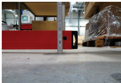
Fot. 3. Niespełnione wymaganie płaskości posadzki
