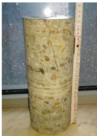
Fot. 6. Odwiert rdzeniowy przez rysę otwartą u góry i nieprzechodzącą przez całą wysokość posadzki – stan zgięciowy Photo 6. Core drilling through the crack open at the top and not going through the entire height of the floor – as a result of bending
