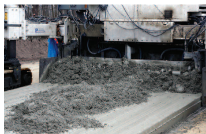
Fot. 1. Układanie górnej warstwy nawierzchni na obwodnicy Malni i Choruli Photo 1. Casting of upper road surface on by-pass road of Malnia and Chorula
