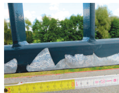
Fot. 3. Korozja powłoki cynkowej stanowiącej podkład pod malarską powłokę proszkową
