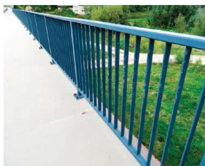
Fot. 1. Barierka stalowa zamontowana na konstrukcji mostowej Photo 1. Steel barrier mounted on the bridge structure
