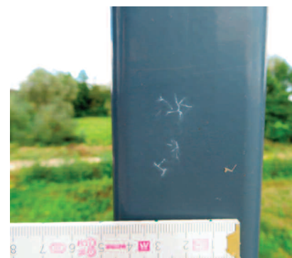
Fot. 2. Wykwity solne na powierzchni powłoki malarskiej
