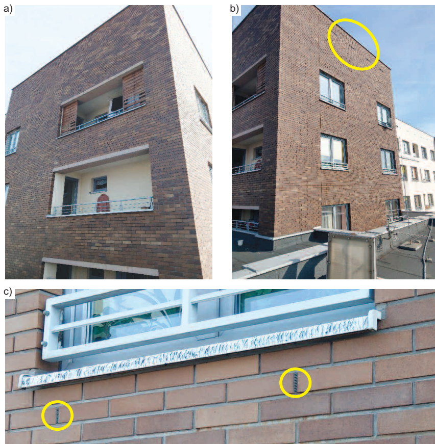
Fot. 4. Elewacja zachodnia (a) i południowa (b) oraz detal podokienny z zaznaczonymi otworami wentylacyjnymi (c)
