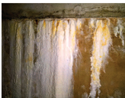
Fot. 4. Przecieki przez konstrukcję niecki basenowej Photo 4. Leaks through the swimming pool basin structure
