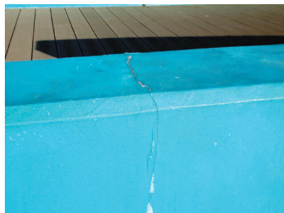
Fot. 3. Zarysowana ściana konstrukcyjna niecki basenowej Photo 3. Cracked structural wall of the swimming pool basin
