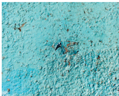
Fot. 2. Uszkodzenie warstwy wykończeniowej powierzchni basenu Photo 2. Damage of the pool surface finish layer
