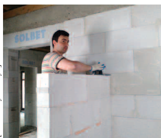
Fot. 2. Wyrównywanie powierzchni wspornej bloczków z ABK za pomocą pacy – w spoinach poziomych widoczny klej świadczący o wypełnieniu spoin na całej szerokości
