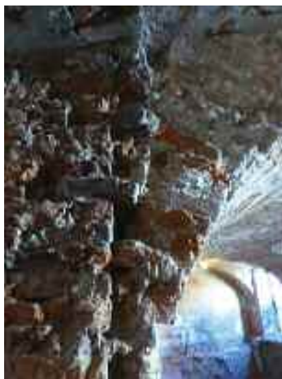
Uszkodzenia strefy podporowej walcowego sklepienia murowego Mechanism of damage to the support zone of the cylindrical stone wall
