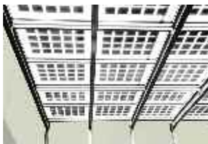
Fotowoltaiczne świetliki w budynku Wyższej Szkoły Technicznej w Katowicach
