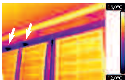
Rys. 3. Termogram okna w pokoju z wyciętymi fragmentami uszczelek w dwóch skrzydłach lewego okna (miejsce napływu powietrza zaznaczono strzałkami)
