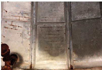
Fot. 2. Powierzchnia stropu zbiornika nr 2 Photo 2. The surface of the roof slab of tank 2
