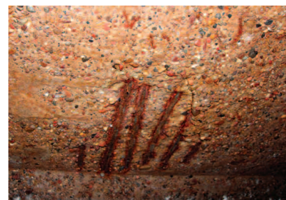
Fot. 1. Uszkodzenia stropu zbiornika nr 2 wywołane działaniem wody miękkiej
